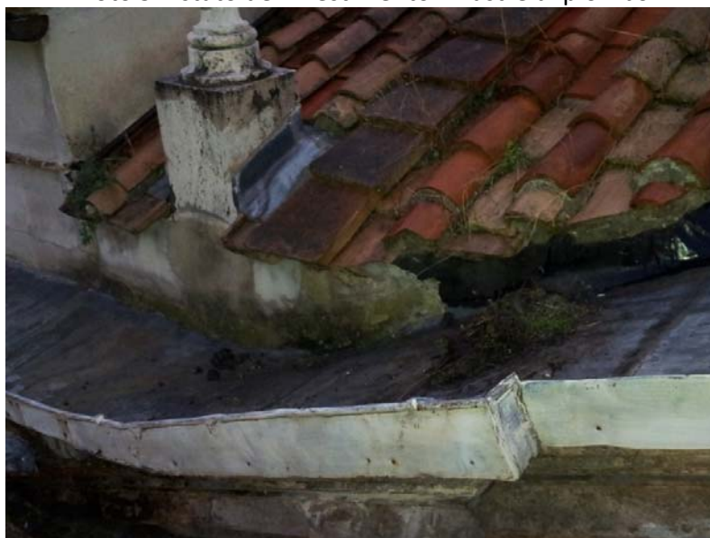
Foto 9 – stato del rivestimento in lastre di piombo
