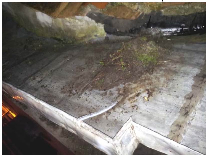
Foto 10 – stato del rivestimento in lastre di piombo
